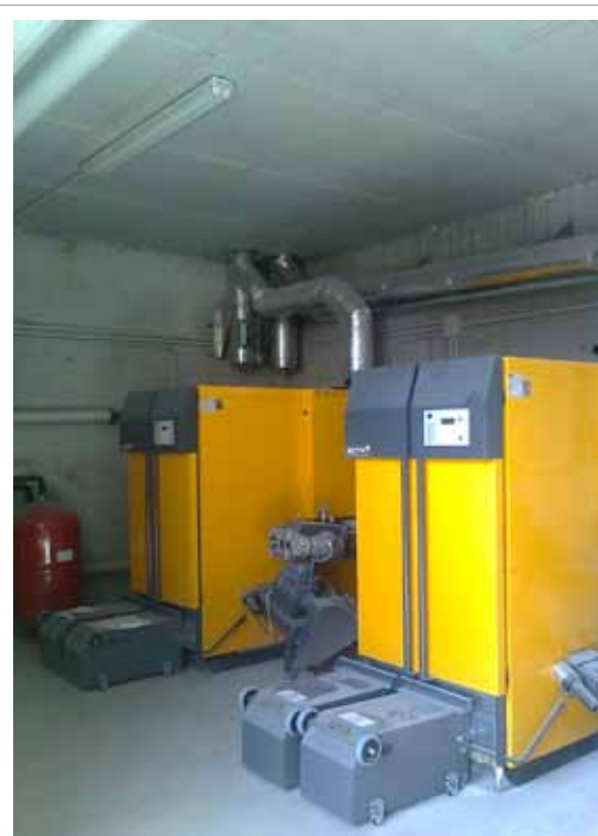
Stazione Forestale Tarvisio: 2x ETA HACK 200 kW
